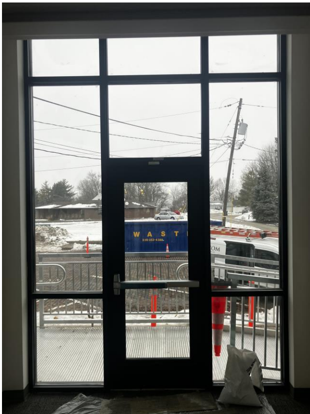
1. Door 100A in Vestibule 100
