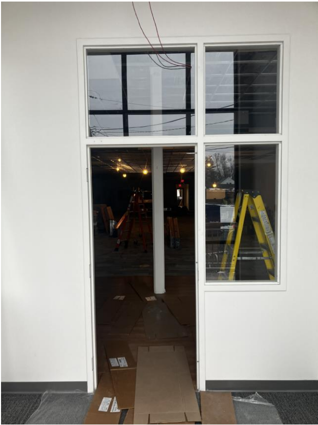
2. Missing Door 100B
