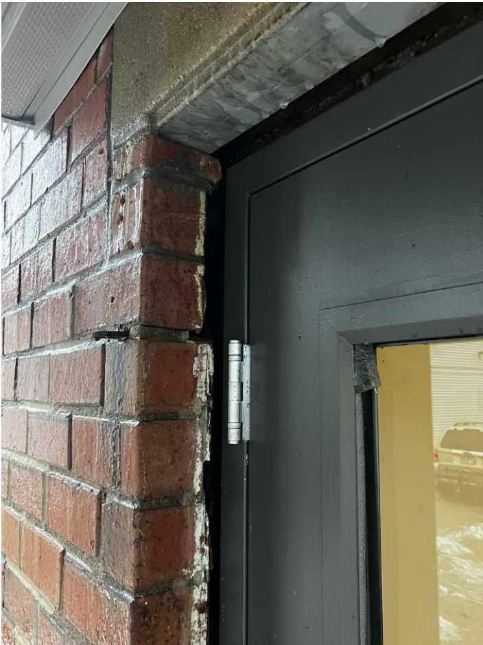
20. Door Frame Condition at Door 116
