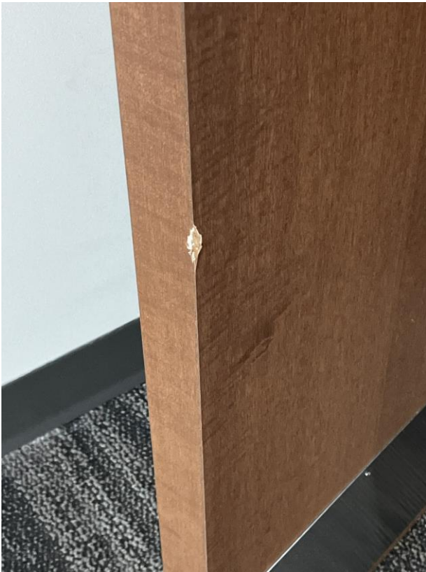
23. Damage at Door 101A
